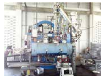
パイロットプラント
