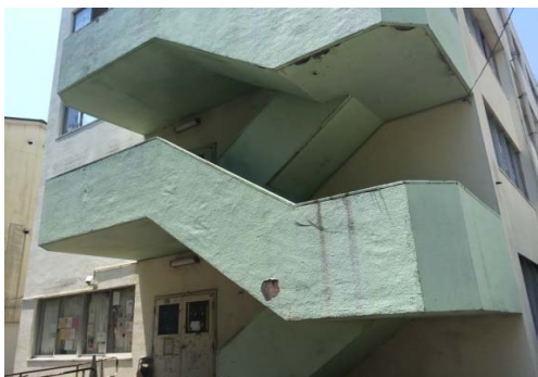
サークル会館は外壁も剥がれるなど至急対策が必要。
