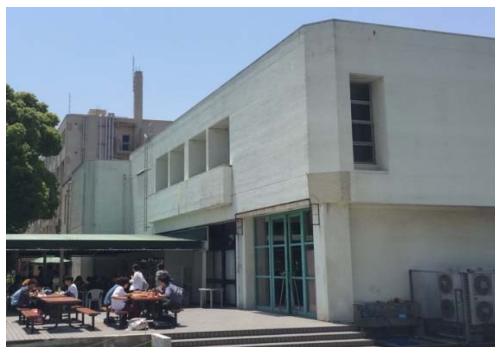
厚生会館(生協食堂)も外観の経年劣化が激しい。
