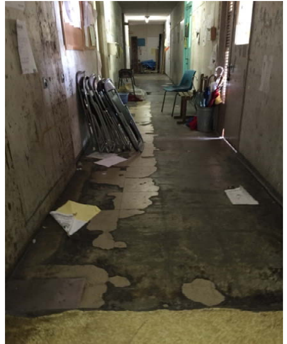
北方キャンパスのサークル会館内部 共有スペースは補修もあまりされておらず、老朽化が進んでいる。
