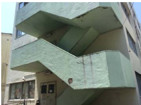
サークル会館は外壁も剥がれるなど至急対策が必要。
