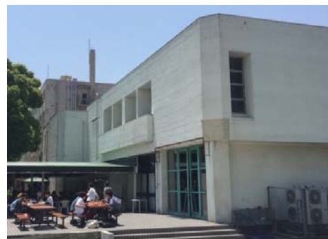
厚生会館(生協食堂)も外観の経年劣化が激しい。
